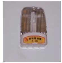
圖13. 緊急照明設備
